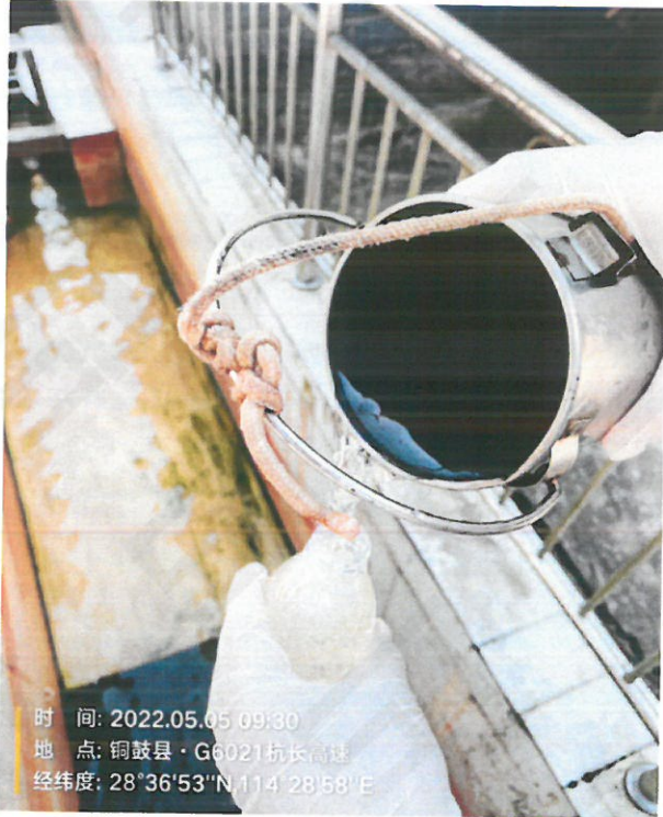
废水进口近景
